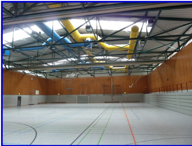
Alte Beleuchtungsanlage der Sporthalle
