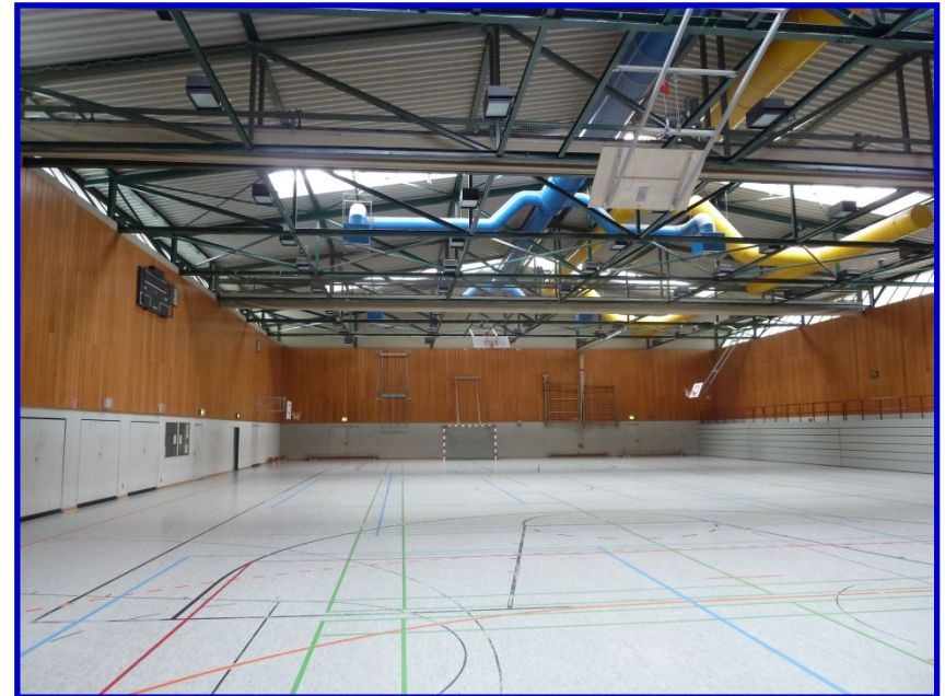
Veraltete Beleuchtungsanlage in der Sporthalle mit konventionellen Vorschaltgeräten (KVG)
